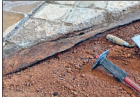
Bild 2 – Stahlträger ohne Korrosionsschutz im Fußboden
