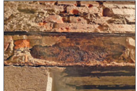
Bild 3 – sich auflösender Stahlträger über Kellerdecke
